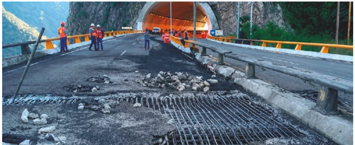
Figura 1. Daños causados por incendio en un puente.
